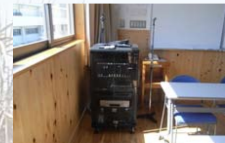
音響 (講義棟レベルの音響設備)
